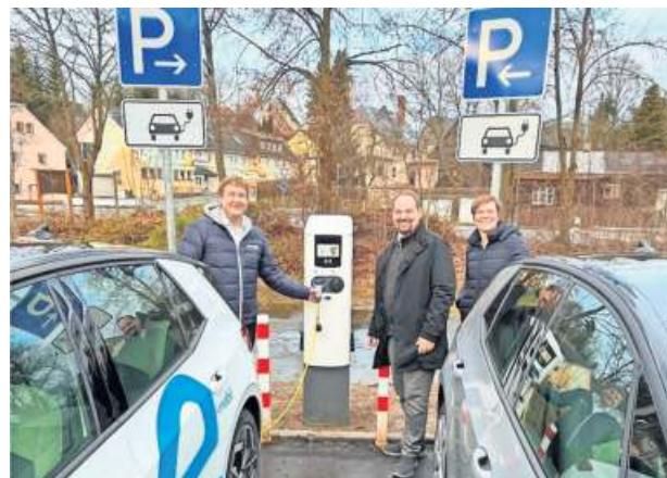
Regnitzlosau: Bayernwerk nimmt E-Ladesäule in Betrieb
